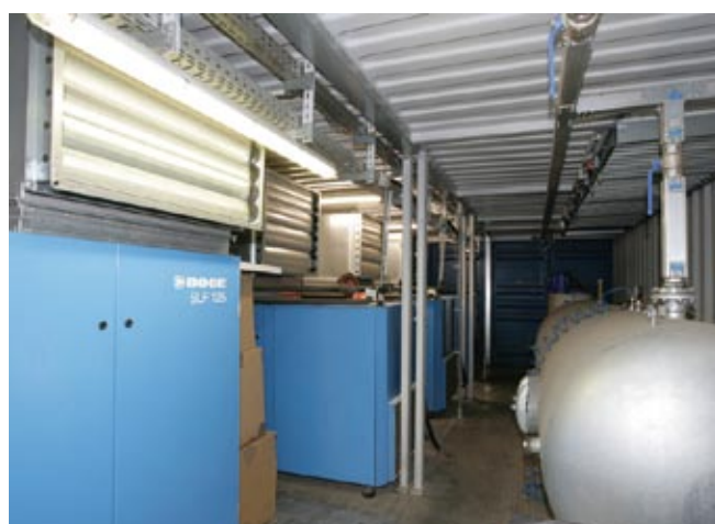
Die BOGE Druckluftanlage ist in einem Container installiert.
